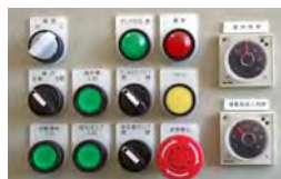
全自動制御盤
